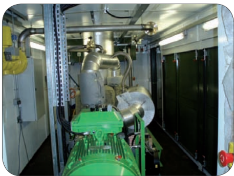
Vykson engine in container
